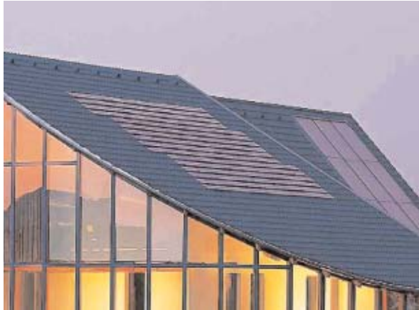
Hausdach mit Photovoltaik und Thermischer Solaranlage
