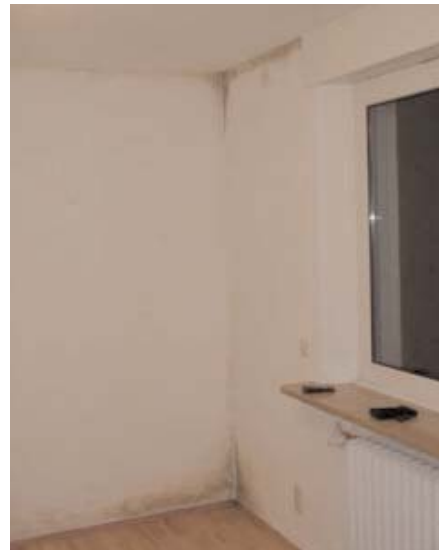
Schimmelbildung in kalten Ecken
