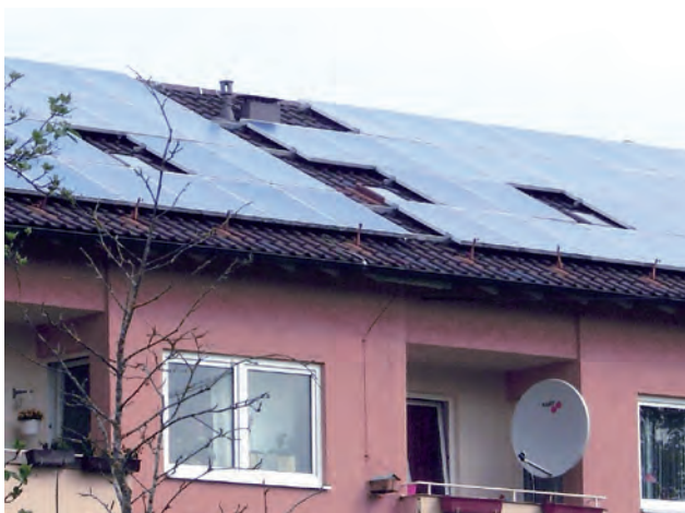
Aussparungen und Unterkonstruktion wirken störend.
