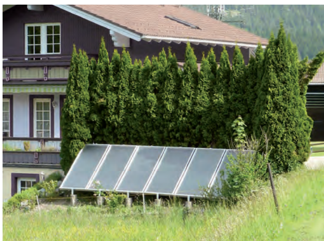
Investitionen in Unterkonstruktion und Solarleitungen und die höheren Wärmeverluste wirken sich nachteilig auf die Wirtschaftlichkeit aus.
