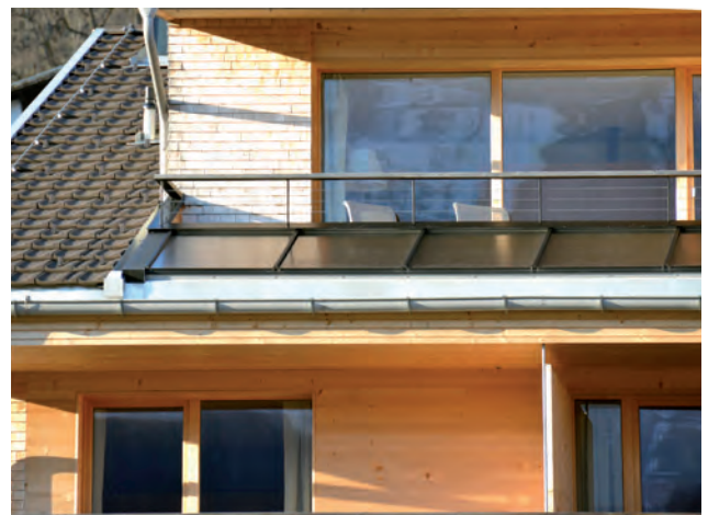
Schön in den Dachüberstand integrierte Anlage.
