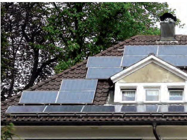
Getrepte Kollektoren beeinträchtigen die Dachform.
