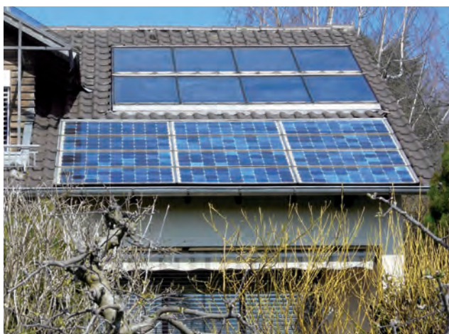
Solaranlagen sind nicht aufeinander abgestimmt.
